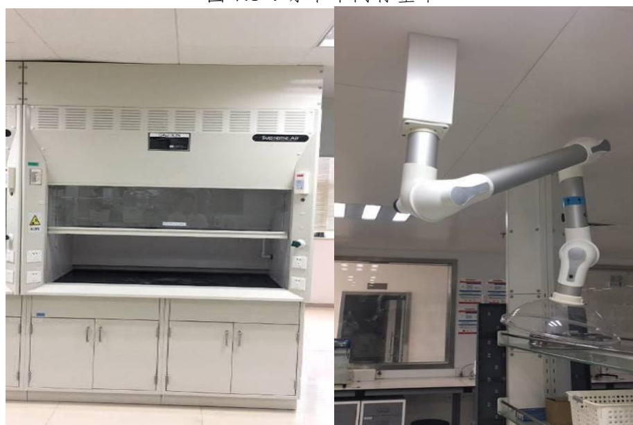
图 7.1-5 QC 检验中心局部排风设施
