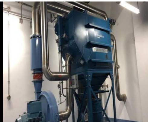
图 7.1-2 固体车间流化床除尘器
