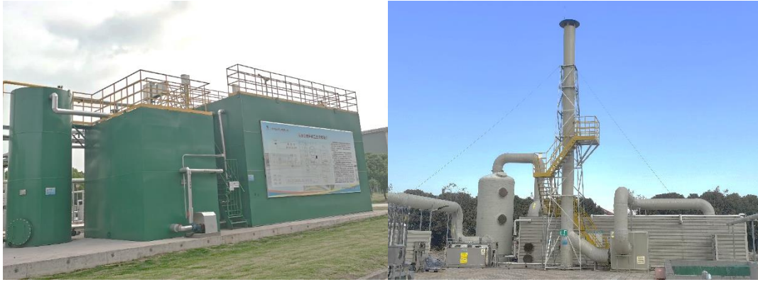
图E-3 新建氮磷废水和废气处理设施
