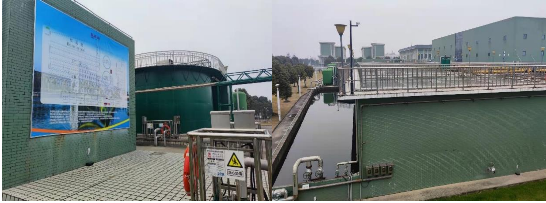
图E-1 污水处理设施
